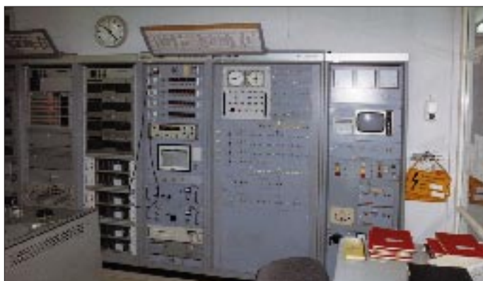
Blick in die Steuerzentrale der Relaisstation Malta. Hier wurden Programme, Sender und Antennen zusammengeschaltet.
